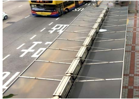
图7.2.5.2 顶棚中间排水
