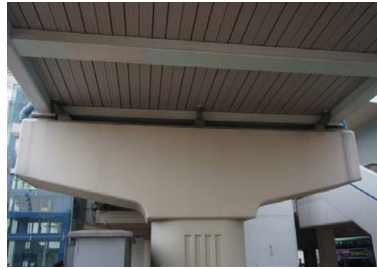
图7.2.5.4 顶棚桥底排水
