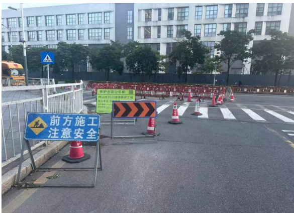
路口位置安全警示、夜间警示、安全雪糕筒等设施设置充分
